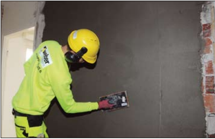
Pinta on nopea tasoittaa linjaarilla edellisenä päivänä asennettuja johteita myöten. Lopuksi pinta vain hierretään kevyesti.
